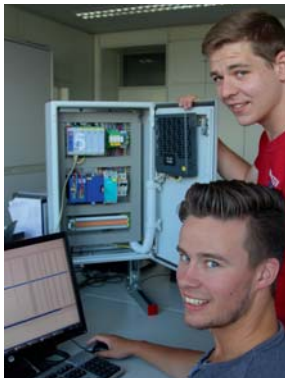
Spezialisten auf dem Gebiet der Fernwirktechnik: Tobias Rudack und Tobias Philipp von Westfalen Weser Netz geben anhand eines aktuellen Projektes einen Einblick in die komplexe Technik mit den SAE-Komponenten.
