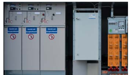
SAE-Schaltschrank in Kompaktanlage
